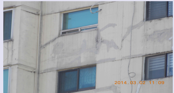
《모서리부 사인장균열 발생 사례》
